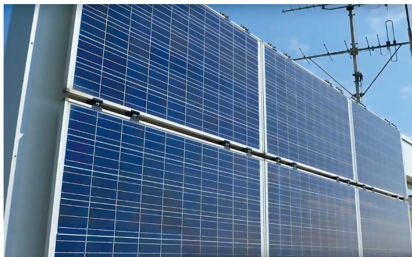
当社屋上に設置しているソーラーパネル
